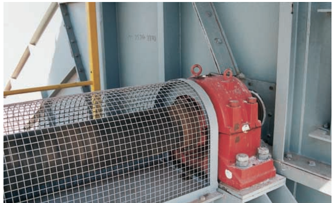
Unidad motriz de un ventilador
